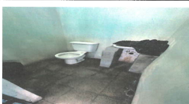
FOTO 2: SERVICIOS SANITARIOS Y SUS ACCESORIOS
